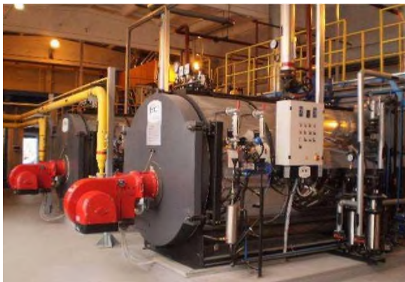
Рис. 5. Газовый котел системы отопления.
