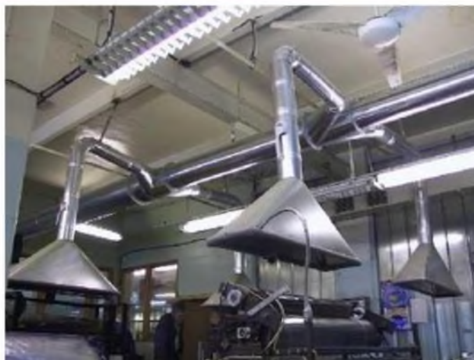
Рис. 1. Вентиляционная система на производстве.
